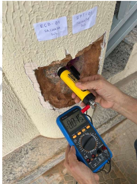
Figura 6 - Procedimento do ensaio de potencial de corrosão
